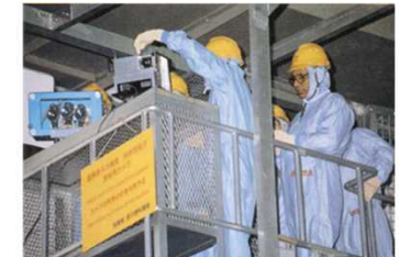
監視装置の保守管理
