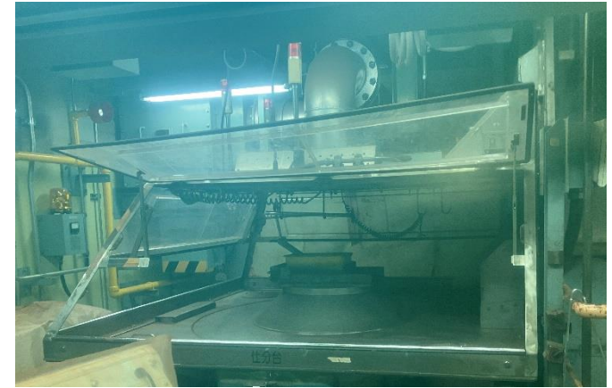
仕分台 (不燃物前処理室)
