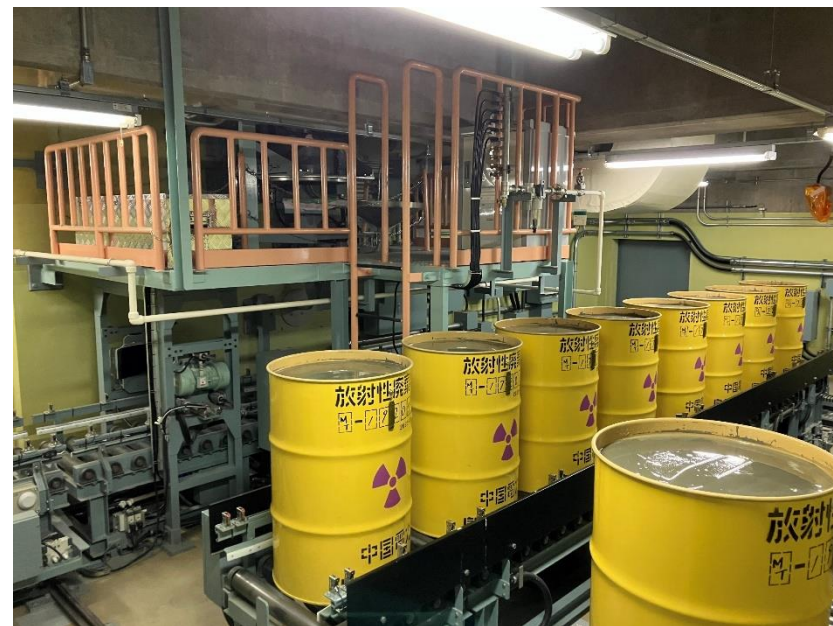
モルタル固化室
