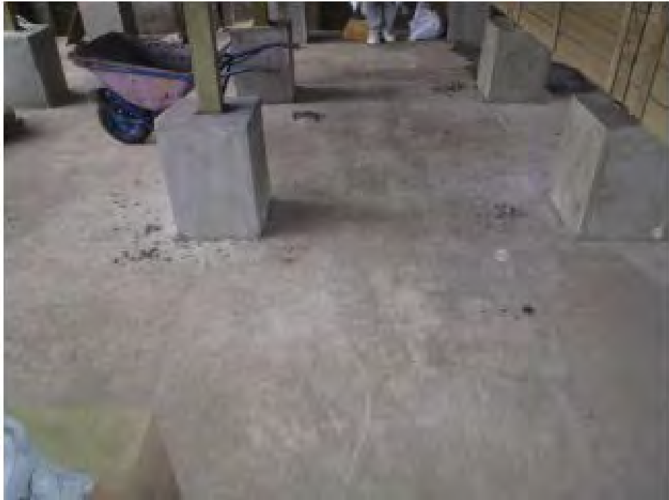
図⑩-3 基礎部ひび割れ補修前の写真
