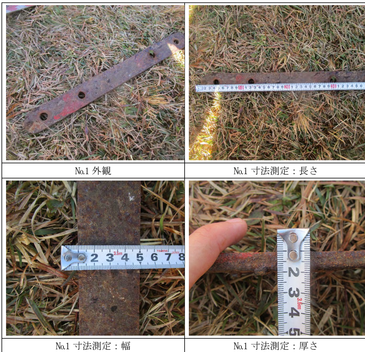
図⑨-1 接合金物の腐食、変形等の状況 (No. 1)
