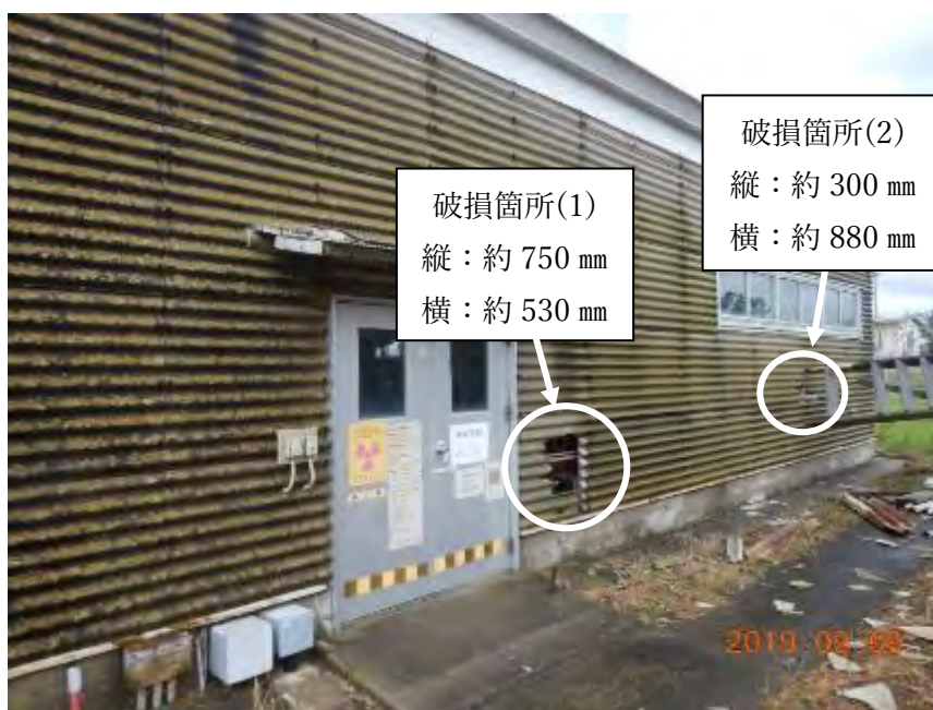
写真① 補修前（令和元年 9 月 9 日撮影）
