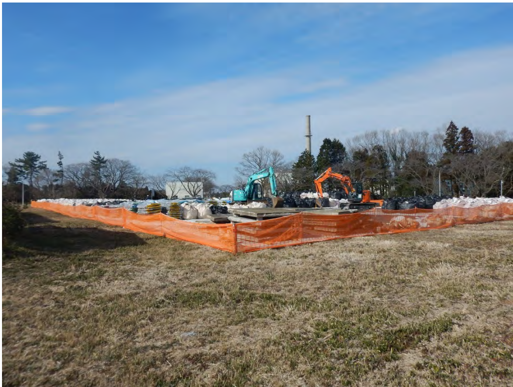
写真⑩ がれき等の保管場所の状況（令和2年2月3日撮影）
