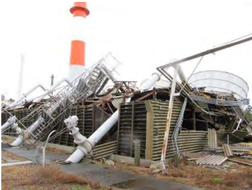
写真② 倒壊後（令和元年9月9日撮影）
