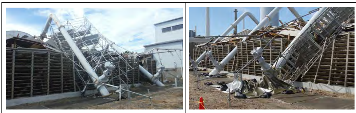
図⑱-2 足場の倒壊状況
