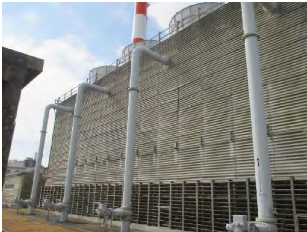
写真① 倒壊前（平成30年2月16日撮影）
