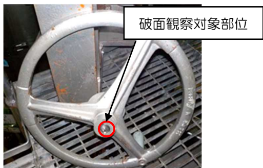
折損した手動操作ハンドル
