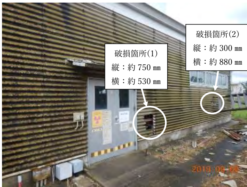
写真① 補修前（令和元年 9 月 9 日撮影）
