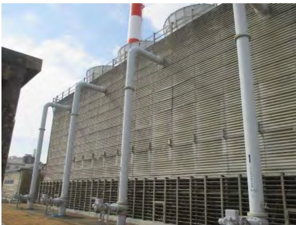
写真① 倒壊前（平成30年2月16日撮影）
