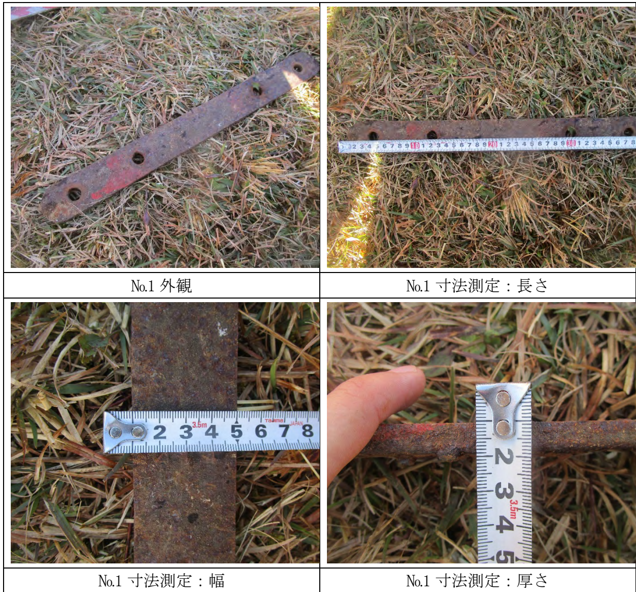
図⑨-1 接合金物の腐食及び変形等の状況 (No. 1)
