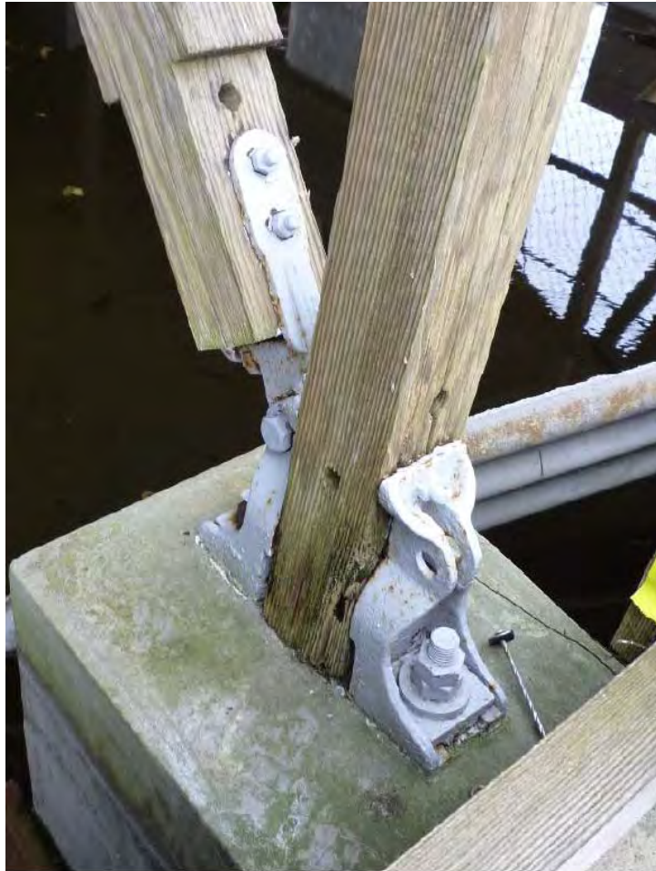
図⑤-1 筋かい下端部の接合部近傍部の写真
