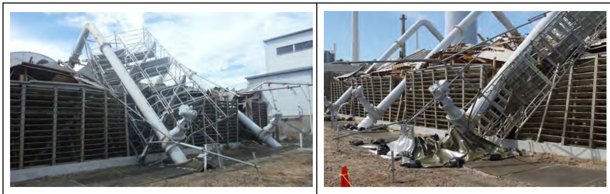
図⑱-2 足場の倒壊状況
