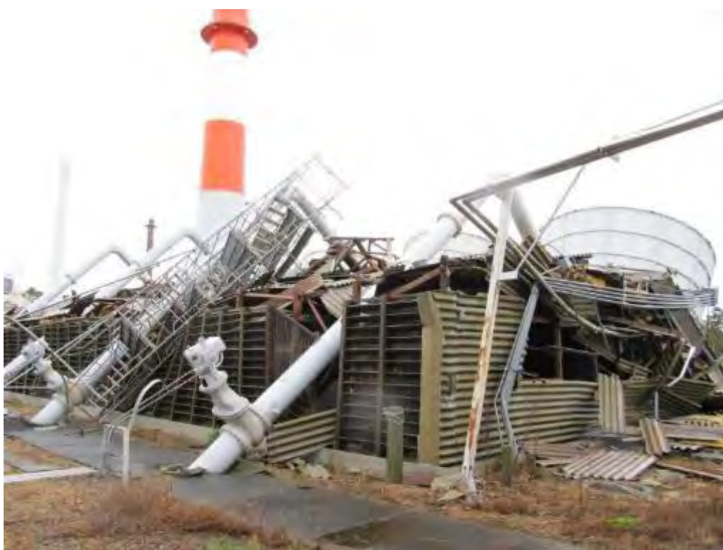
写真② 倒壊後（令和元年9月9日撮影）
