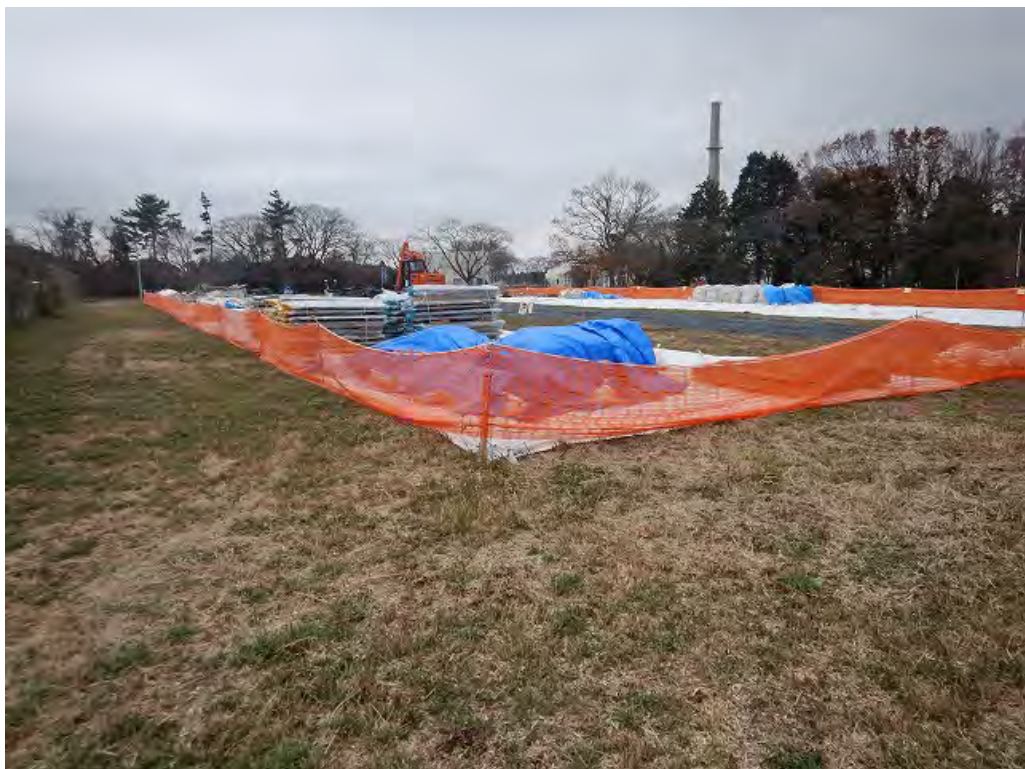
写真⑧ がれき等の保管場所の状況（令和元年12月11日撮影）
