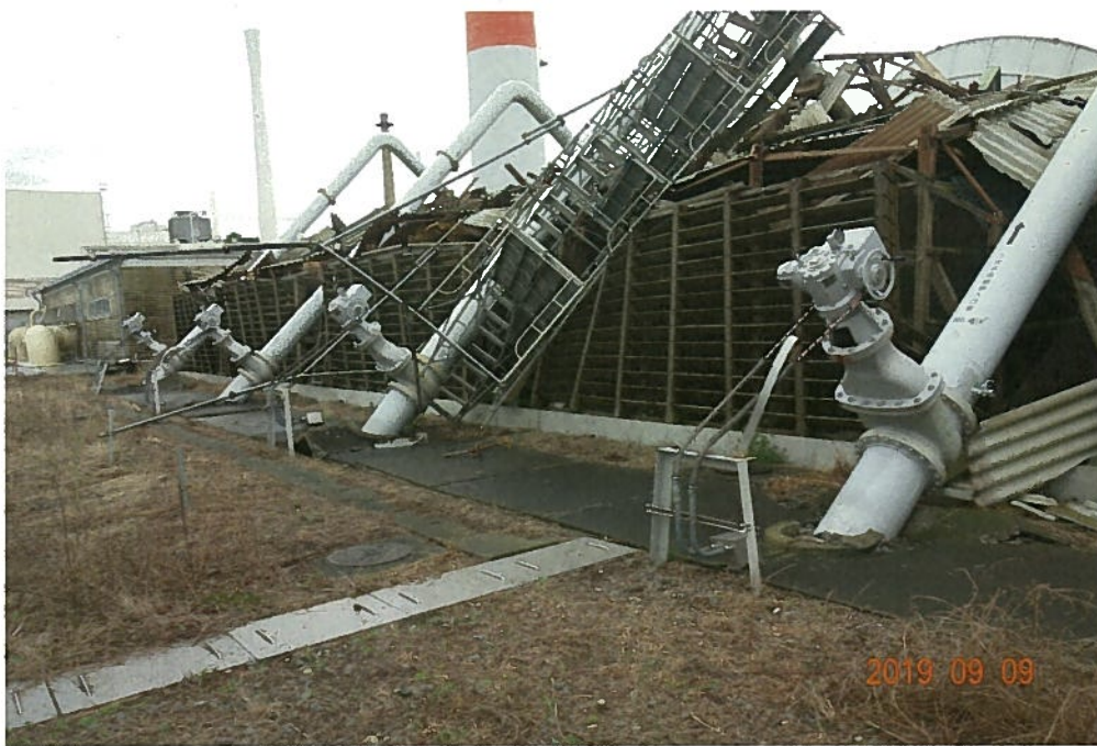
写真③ 倒壊後 東側（令和元年9月9日撮影）
