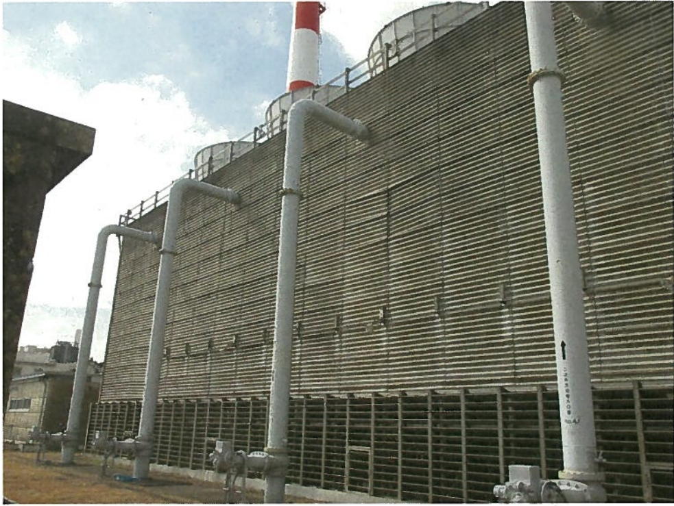
写真① 倒壊前（平成30年2月16日撮影）
