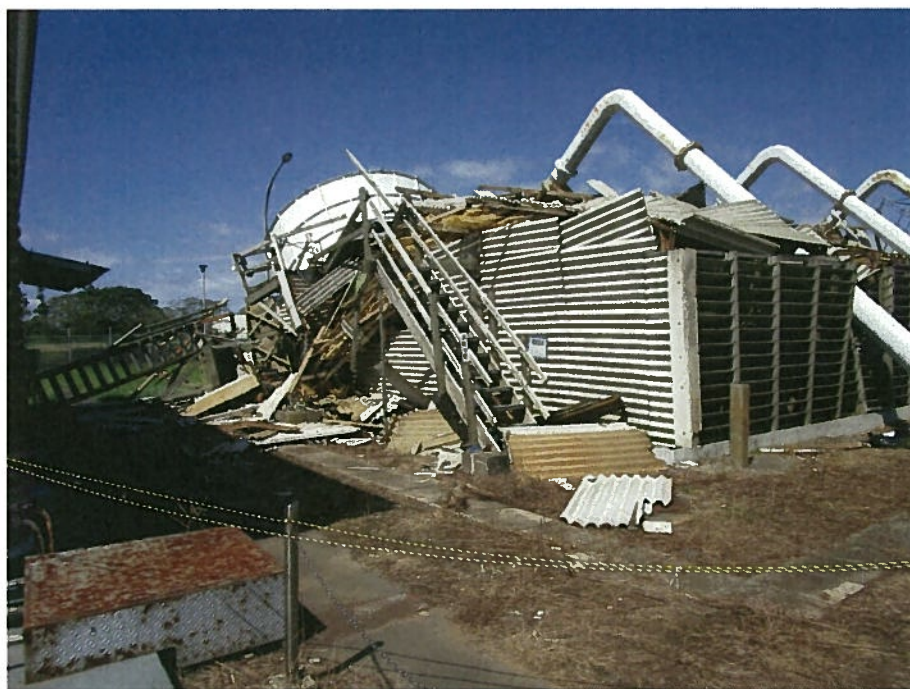
写真⑥ 倒壊後 南側（令和元年9月12日撮影）
